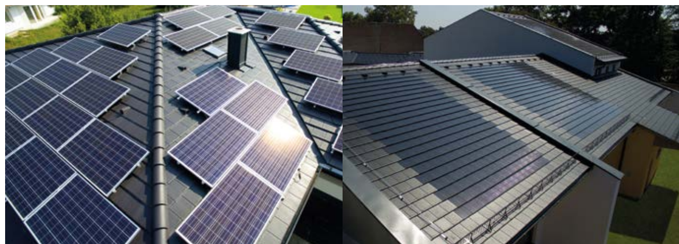
Klasičan solarni sistem s velikim panelima.
